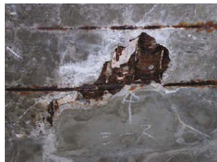
写真3 鉄筋の剥離・露出
