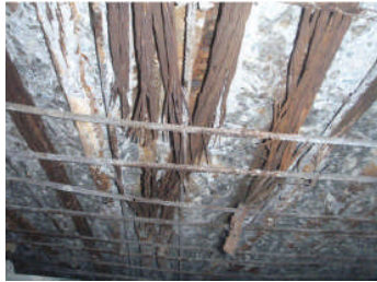
写真4 PCケーブル破断
